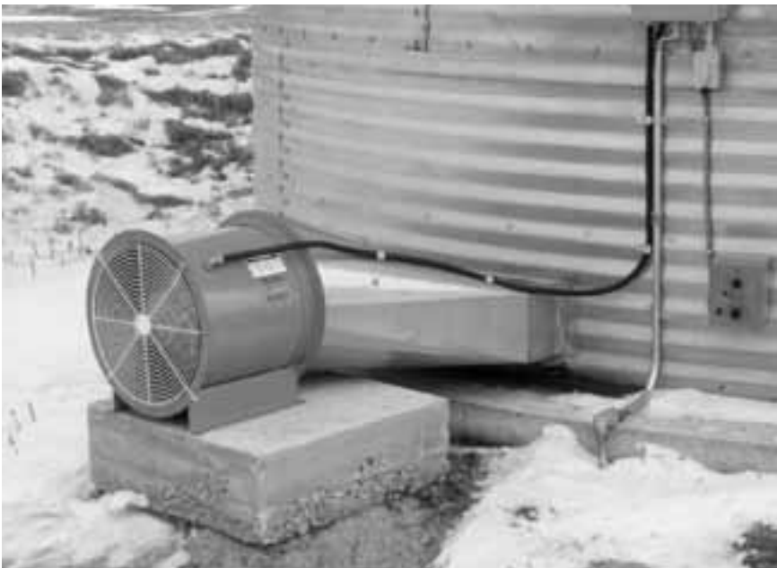
Figure 2. Unité de ventilation.
